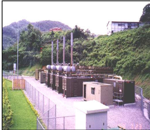
山豬窟沼氣處理發電設施 (5.45 MW/可寧衛公司營運)
