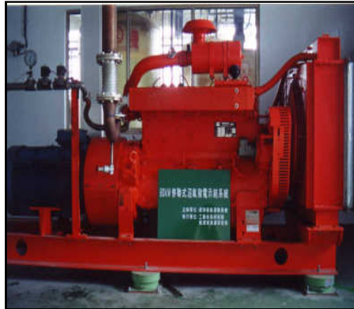
沼氣併聯發電示範系統 (80 kW *2/統一公司新市廠)
