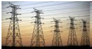
能源基礎設施
